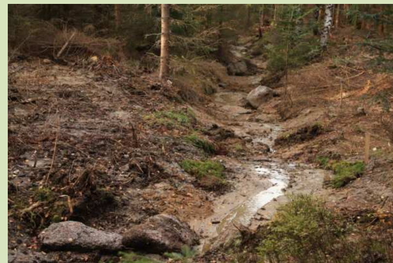
4. Vymělčení a rozvlnění odvodňovacího kanálu (kanál byl vybudován přímo v trase potoka)
