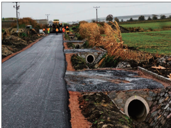
Obr. 1. K.ú. Choťovice okres Nymburk, HPC 49 s přeložkou trafostanice – 7,5 mil. Kč
