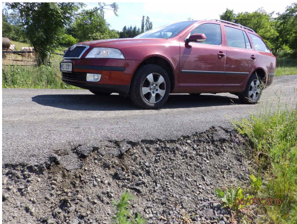
Špatně zhutněná a trhající se krajnice, sesypávání boků konstrukce
