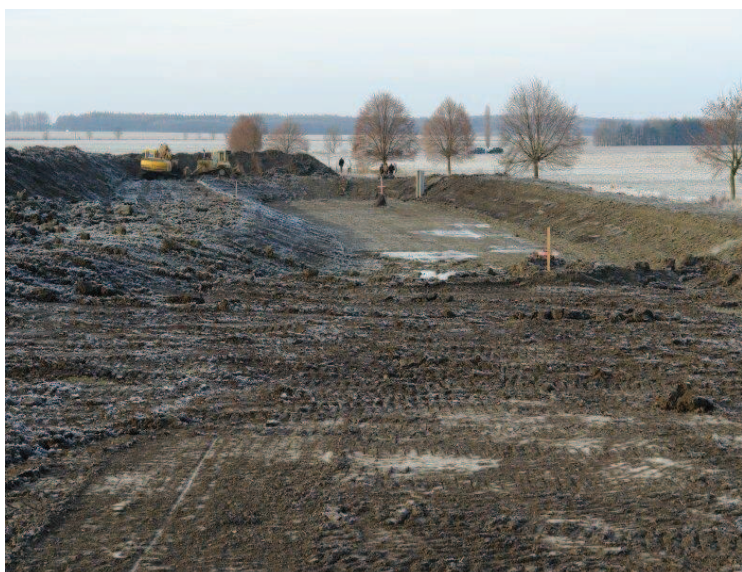
Obrázek 25: Stav před realizací
