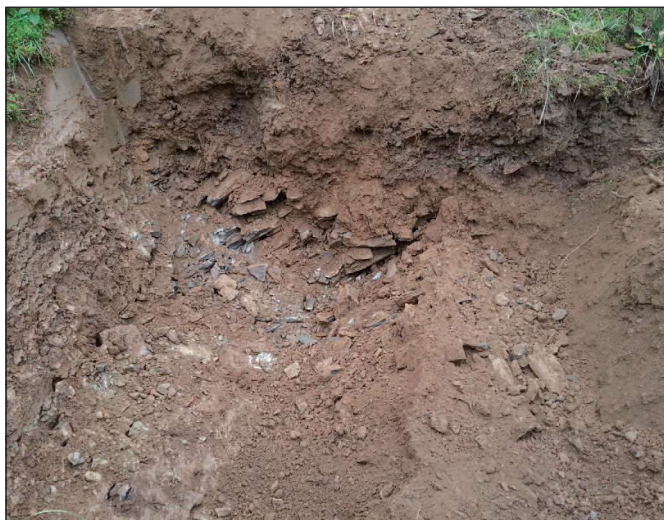
Obr. 7 Obnažený geologický profil ve stěně návodní strany hráze pod úrovní základové spáry. Stav sondy 11.11. 2015 před prováděním sanace. Nesoudržné zeminy tvořené úlomky fylitické břidlice a propustný materiál, způsobující průsak a pokles povrchu terénu. Stejně nebezpečné jsou pukliny v hornině objevené v hloubce 2,7 m
