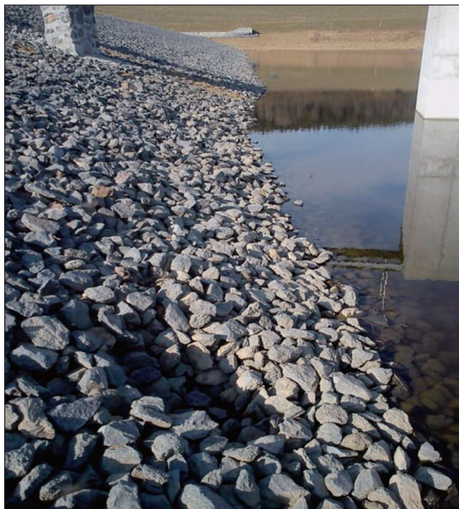
Obrázek 6 Objevená proláklina v tělese hráze po vypuštění v březnu 2015 →
